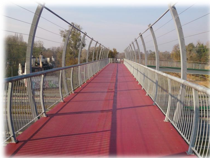
Foto.30. Kładka pieszo-rowerowa nad drogą i torami kolejowymi w terenie niezabudowanym wykonana z kompozytów i stali. Źródło: archiwum własne M&G
